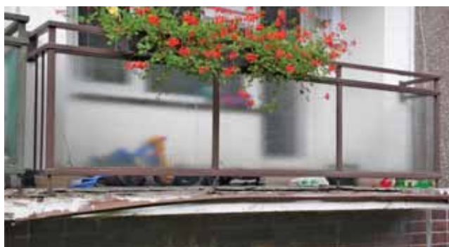
Najčastejšia porucha starého zábradlia
